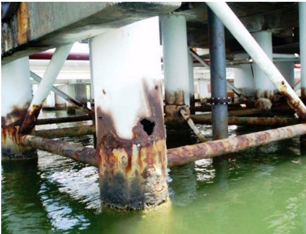
Figura 2 - Corrosão em zona de variação de maré
