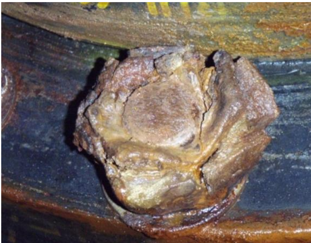
Figura 1 - Processo de corrosão avançada
